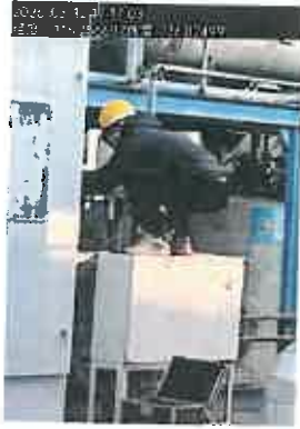
DA060 尾气回收装置 排气筒 (进口)
