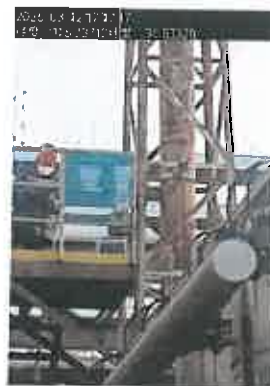
DA060 尾气回收装置 排气筒 (出口)
